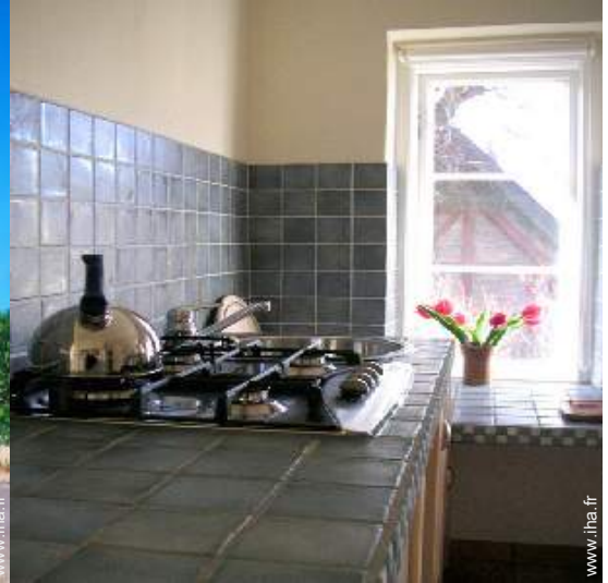
cuisinière à gaz
